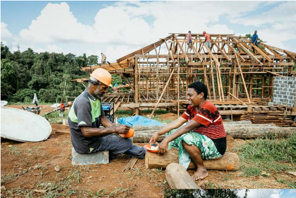
Luisa Curuki hat ihrem Mann Rakula etwas zu essen mit auf die Baustelle gebracht (oben). Projektleiterin Selai Toganivalu begutachtet das Drainagesystem (unten). Der anspruchsvolle Bau erfüllt hohe Qualitätsstandards.
