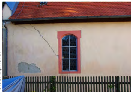
Mit bloßem Auge erkennbare große Risse.
